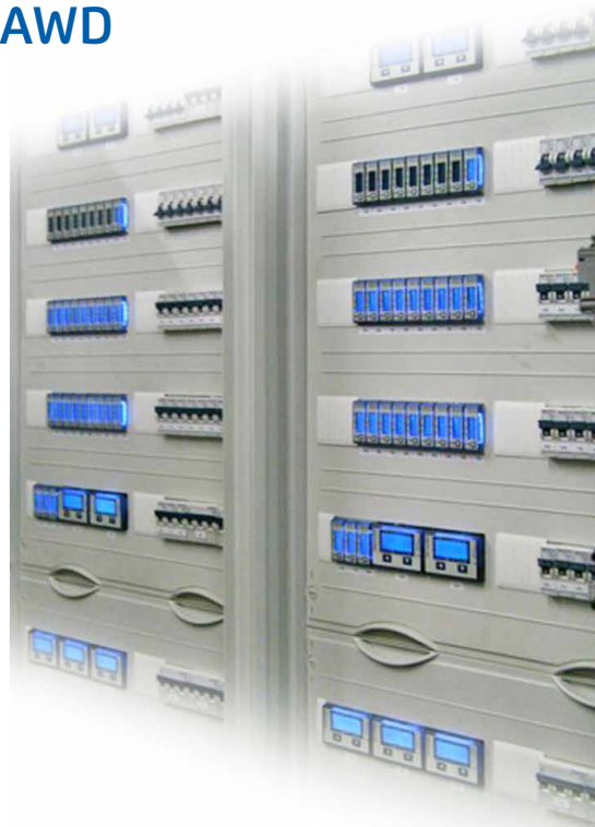
Nombreux compteurs d'énergie dans un espace réduit ►
