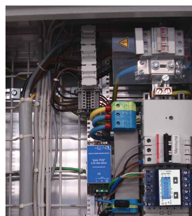
▲ Transformateur de courant intégré directement dans le chemin de câbles
