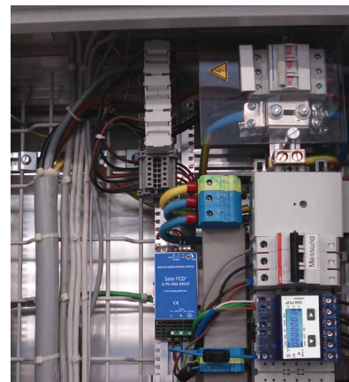
▲ Eingebaute Stromwandler direkt im Kabelkanal
