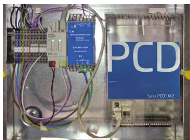
Anbindung an eine bestehende EIB/KNX-Installation für eine Web-Anbindung von Konferenzräumen
