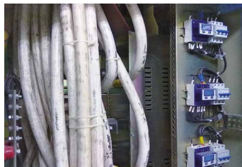
▲ Contatori di energia in ambiente industriale gravoso
