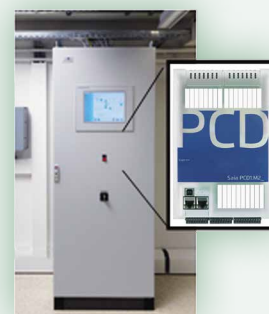
Possibilità di utilizzo Quadro elettrico primario
