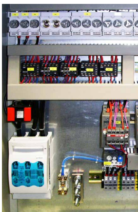
▲ Trasformatore amperometrico nell'armadio elettrico
