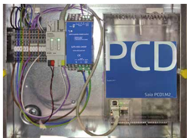
Collegamento a un'installazione EIB/KNX esistente per la connessione web di sale conferenze
