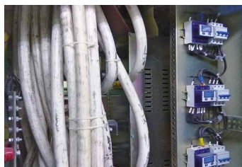
▲ Contatori di energia in ambiente industriale gravoso
