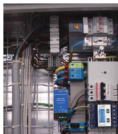
▲ Trasformatori amperometrici installati direttamente nella canaletta dei cavi
