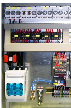
▲ Trasformatore amperometrico nell'armadio elettrico
