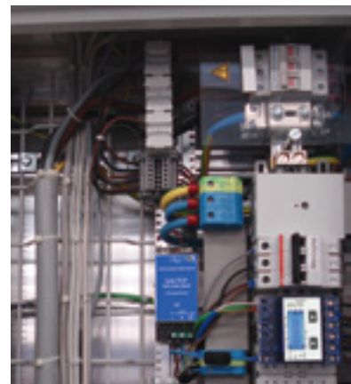
▲ Eingebaute Stromwandler direkt im Kabelkanal
