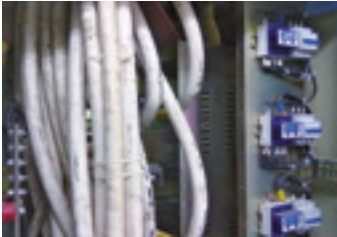
▲ Energiezähler in rauher industrieller Umgebung
