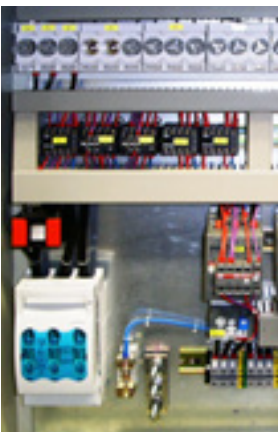
▲ Stromwandler im Schaltschrank
