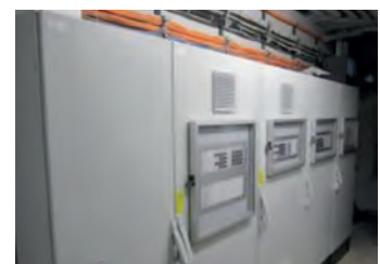
▲ Switch cabinets „Yukon Bay“
