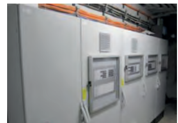
▲ Switch cabinets „Yukon Bay“
