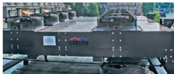
Die farblich angepasste Rückkühleinheit auf dem Dach
