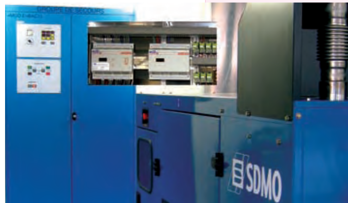
Steuerung für Notstromaggregat
