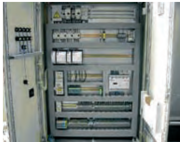
Schaltschrank einer kleineren Anlage
