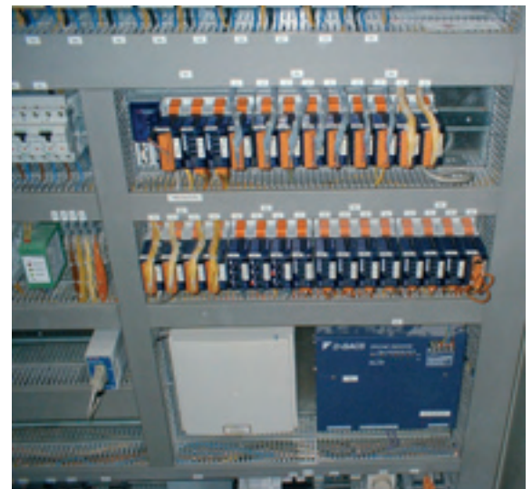
Schaltschrank mit der Saia®PCD3 BACnet® Station (oben links) und dem Daikin Gateway D-BACS (unten rechts)
