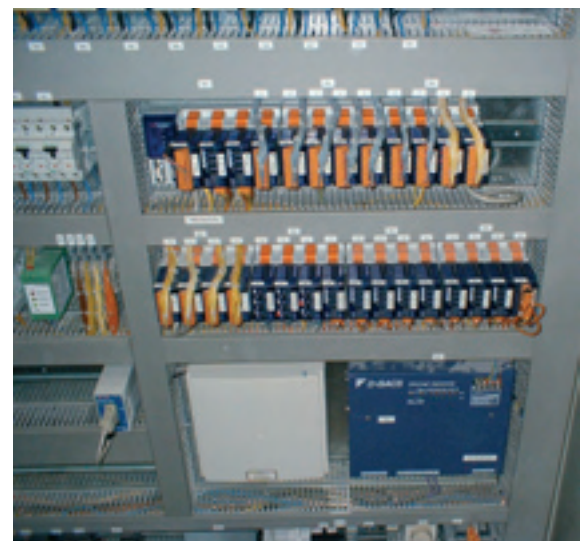
Schaltschrank mit der Saia®PCD3 BACnet® Station (oben links) und dem Daikin Gateway D-BACS (unten rechts)
