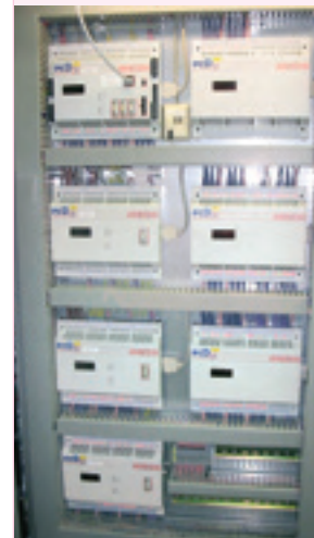
Schaltschrank mit installierten Saia®PCD2 Steuerungen.
