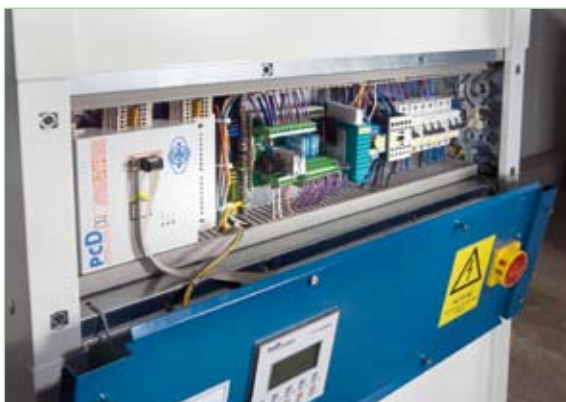
Engste Platzverhältnisse in der Slim-Line: Flache Bauform der Saia®PCD1 passt optimal. Vorortbedienung erfolgt über das Bedienterminal Saia®PDC7.D231. Selbst in der kleinen PCD1 ist der Web-Server für die Web-Visualisierung Standard.
