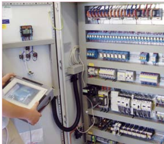
Schaltschrank für HLK-System mit Saia®PCD3 und abgesetztem 10,4" Web-Touch-Panel
