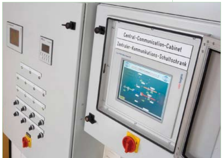
Zentraler Kommunikations-Schaltschrank in der HANSA-Zentrale: Web-Zugriff auf alle Anlagen im Feld.
