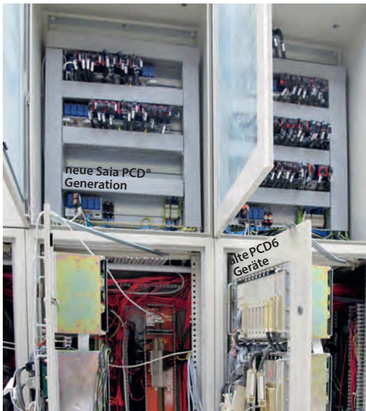
▲ Bilder vom neuen (oben) und alten (unten) Schaltschrank. Der neue Schrank mit PCD3 wurde installiert und getestet, ohne die Produktion mit den «alten» PCD6-Geräten zu stoppen
