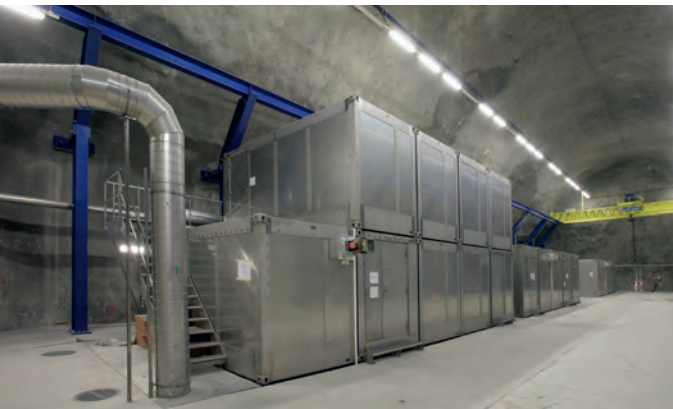
▲ Eine von 8 Tunnelkavernen. In den klimatisierten Edelstahl-containern ist die Bahntechnik untergebracht.
