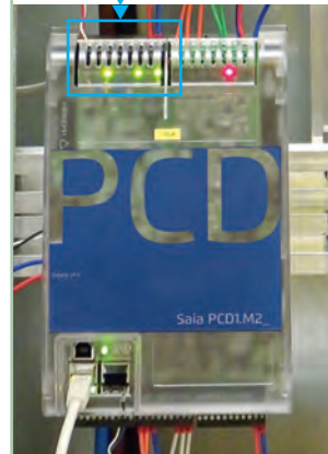
▲ Ausschnitt Schaltschrank PCD1.M2120 mit M-Bus-Modul
