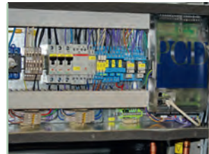
▲ Ausschnitt vom Schaltschrank des Lüftungstowers mit PCD1
