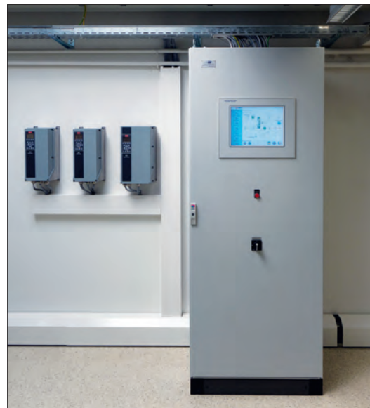
▲ Schaltschrank der Schulungslüftungsanlage (POM Gold zertifiziert)
