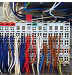
▲ Frontbild: Kabelgewirr bei Schleibchensteuersystem. Abschreckend komplex und fehleranfällig für den Servicefall.
