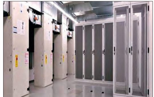
▲ Serverraum Rechenzentrum Wusys Über 500 Energiezähler und Steuerungen ohne Leitsystem
