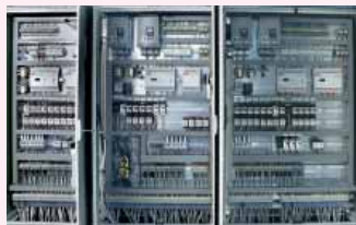
Armoires électriques renfermant les Saia®PCD2.M120 et leurs extensions
