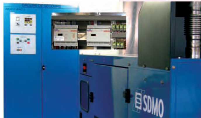
Contrôle pour la génératrice de secours
