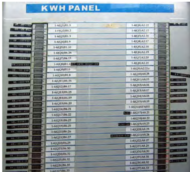
Facturation de la consommation électrique des différents magasins du centre
