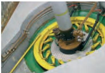
Turbine Francis avec génératrice de 800 kW
