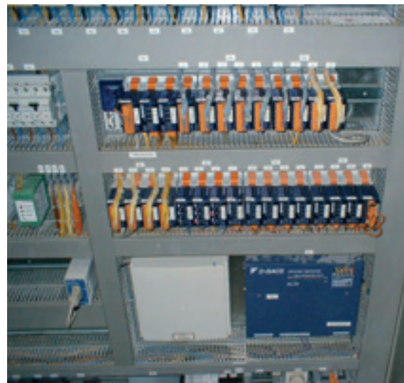
Armoire abritant le Saia®PCD3 (en haut à gauche) et la passerelle D-BACS de Daikin (en bas à droite)
