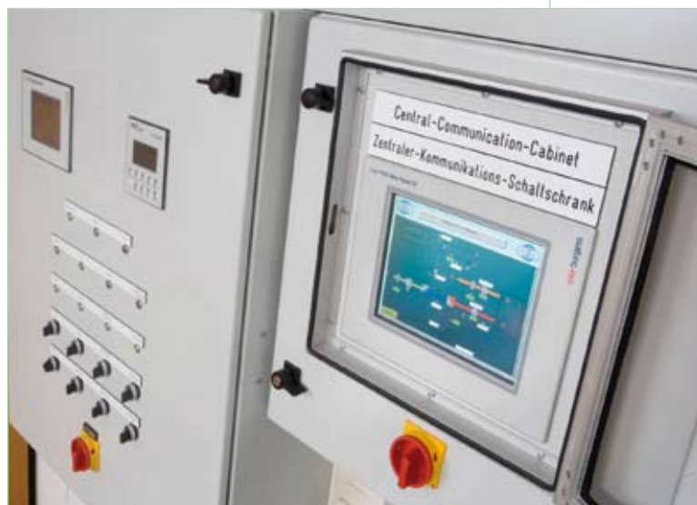
Armoire de communications principale située à la centrale d'Hansa. Accès Web à toutes les installations.
