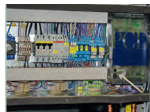
▲ Section de l'armoire de commande de la tour de ventilation avec PCD1
