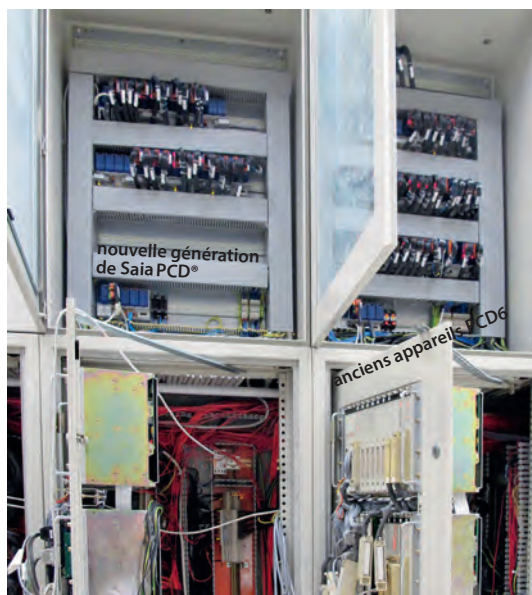
▲ Images de la nouvelle armoire de commande (en haut) et de l'ancienne armoire de commande (en bas). La nouvelle armoire équipée du PCD3 a été installée et testée sans interrompre la production avec les «anciens» appareils PCD6
