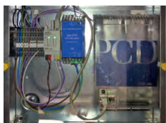
◀ Liaison EIB/Web PCD1.M2120 sur le réseau EIB existant
