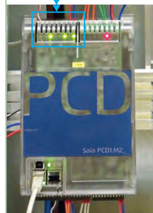
▲ Section armoire de commande PCD1.M2120 avec module M-Bus
