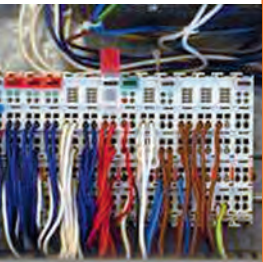
▲ Image frontale : câbles entremêlés pour le système de commande en tranche. Complexité décourageante et source d'erreurs en cas de maintenance.
