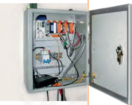
▲ PCD3 destiné à enregistrer les valeurs des compteurs – l'installation n'est pas toujours conforme aux normes
