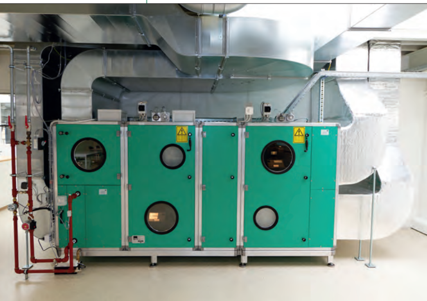
▲ Centrale de traitement d'air pour la formation
