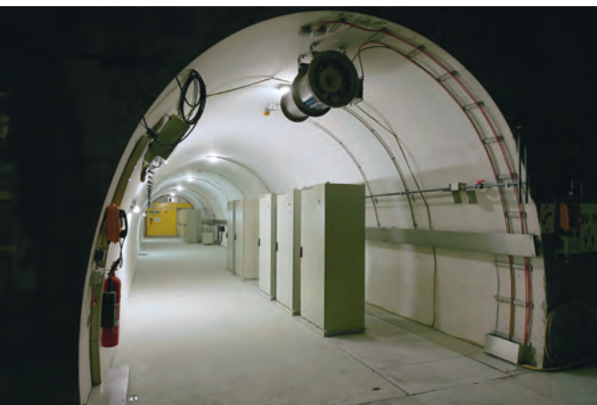
▲ Uno dei 104 tunnel di connessione. In ognuno di questi tunnel sono installati 15 quadri di controllo
