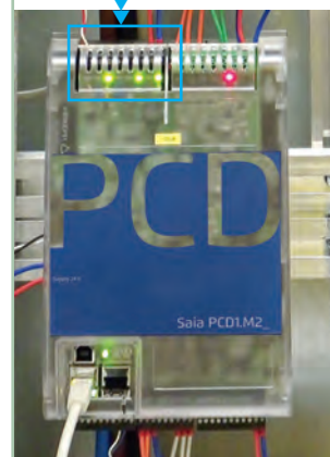
▲ Vista del quadro elettrico PCD1.M2120 con modulo M-Bus
