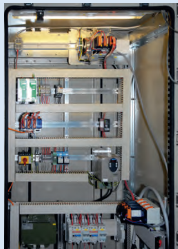
Quadri di controllo dopo i lavori di ottimizzazione
