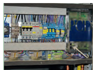
▲ Vista del quadro elettrico della torre di ventilazione con PCD1
