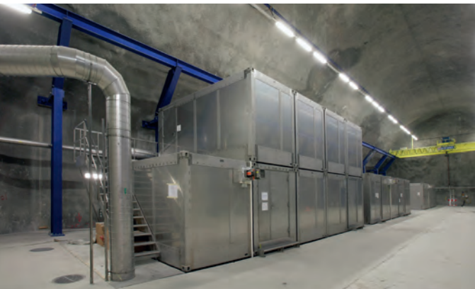
▲ Una delle 8 nicchie. I container climatizzati in acciaio inox contengono i sistemi di controllo ferroviari
