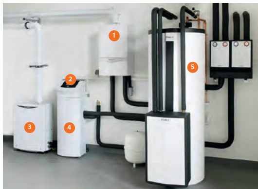
▲ Sistema di microgenerazione di Vaillant Fonte: Vaillant-Group
