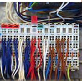
▲ Vista frontale: groviglio di cavi in un sistema di comando a moduli. Spaventosamente complesso e soggetto a errori in caso di necessità di assistenza.
