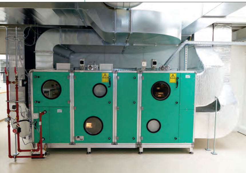
▲ Sistema di ventilazione
