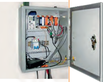
▲ PCD3 per l'acquisizione dei valori dei contatori - non sempre tutto è installato in conformità con gli standard
