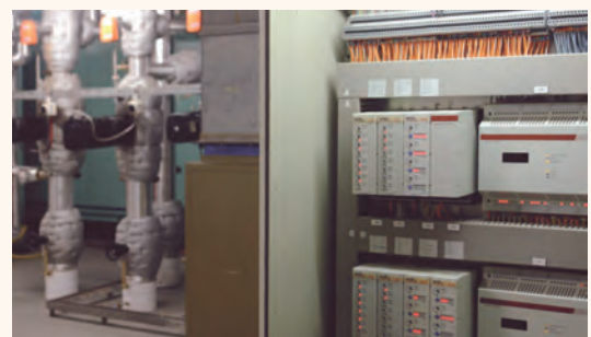
▲ Impianto principale dell'ospedale AMC con "veterani" PCD4 e PCD2 nel quadro elettrico.
