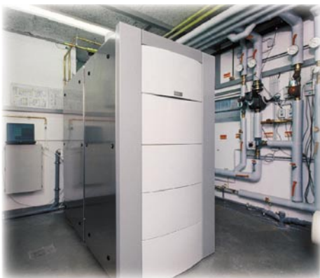
foto: Vaillant GmbH verwarmingstoestel met brandstofcel in de veldtest
