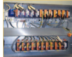
Saia®PCD3-installatie in de post- en vrachtterminal
