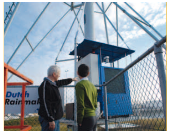
Compressor en schakelkast direct aan de voet van de windmolen
