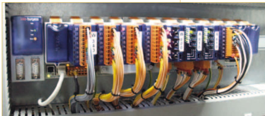
Nieuwe Saia®PCD3-automatiseringsstations bij AMC
