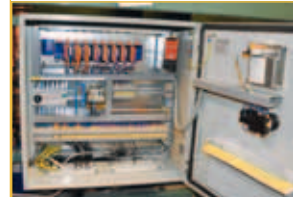
Schakelkast met Saia®PCD3-sturing en PCD7.D232-panel
