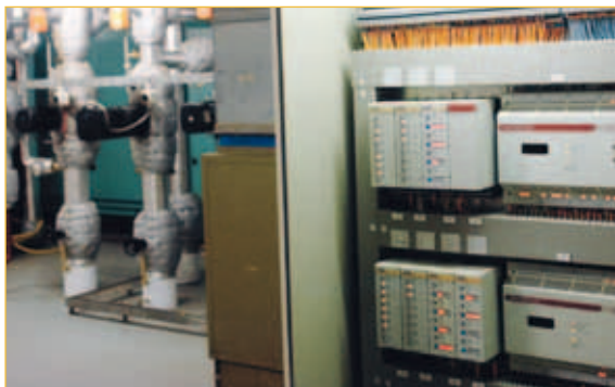
Oude installatie bij AMC met Saia®PCD4-systemen
