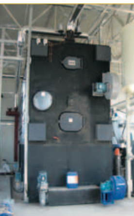
Verwarmingscentrale in de Oekraïne
