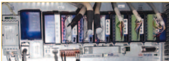
Saia®PCD3 met SD-flashkaartmodule Saia®PCD3.R600 in de post- en vrachtterminal
