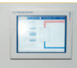
lokale bediening via het 10" Saia®PCD Micro-Browser Web Panel op de schakelkast
