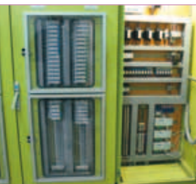
Totaaloverzicht van de schakelkast inclusief bestaande Landis+Gyr-datapuntmodules
