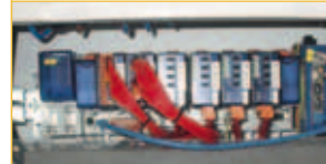
Een van de Saia®PCD3-besturingen in het gebouw van Infocontrol Lda
