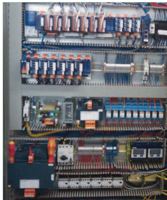
Typische schakelkast van een grote installatie van Agila met Saia®PCD3, een Saia®energiemeter en Saia® Switch
