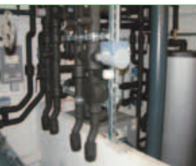
De ATMOVA-installatie van Swissmetal wint warmte uit bronzen dakpannen. De installatie wordt met Saia®PCD techniek gestuurd
