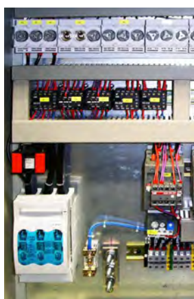
▲ Transformateur de courant en armoire électrique
