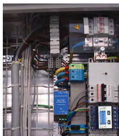
▲ Transformateur de courant intégré directement dans le chemin de câbles
