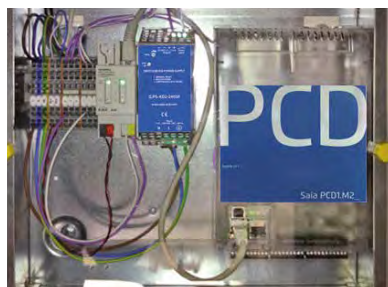
Collegamento a un'installazione EIB/KNX esistente per la connessione web di sale conferenze
