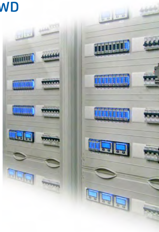
Molti contatori di energia in uno spazio molto ristretto ►
