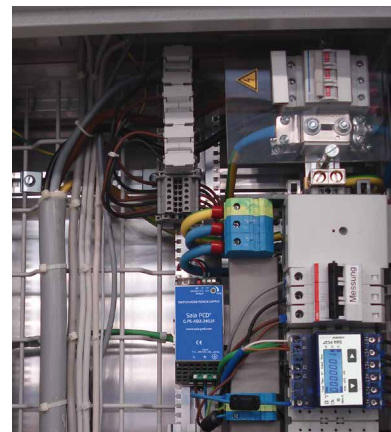
▲ Eingebaute Stromwandler direkt im Kabelkanal
