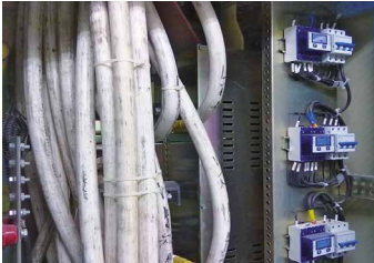
▲ Energiezähler in rauher industrieller Umgebung
