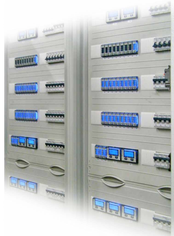
Viele Energiezähler auf kleinstem Raum ►
