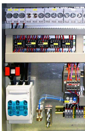
▲ Trasformatore amperometrico nell'armadio elettrico
